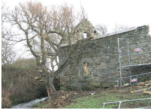
La toiture et une partie des murs sont détruits par la tempête de 1987.
