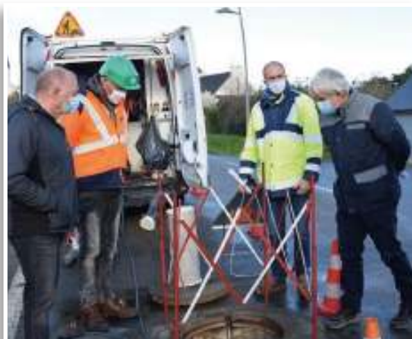
↑ Réseau d'assainissement , Chemin de la Corniche.
