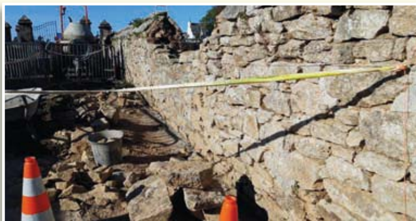
↑ Mur effondré, érosion due aux fortes pluies
