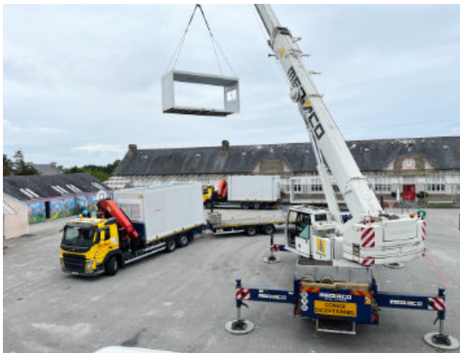
2 classes en modules Algeco ont été installées pour la durée des travaux
